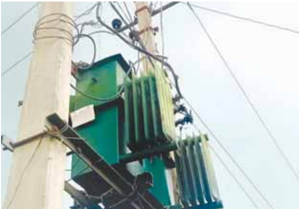
लहरपुर-खराब पड़ ट्रान्सफार्मर
