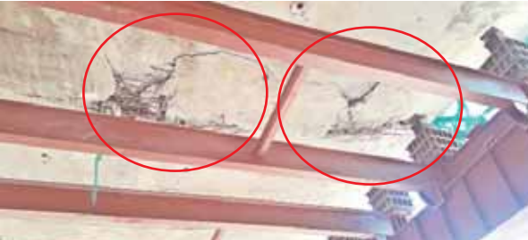
एलीवेटेड मार्ग के निर्माणाधीन फ्लाईओवर में आई दरार। लाल घेरे में।
