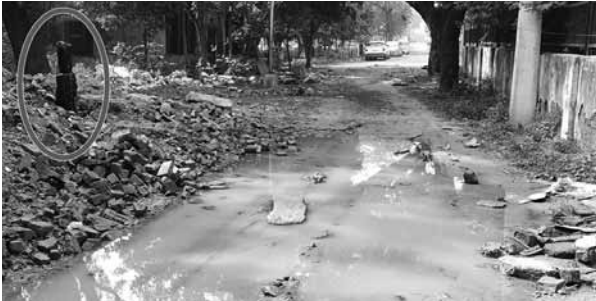
बीके अस्पताल में पाइप लाइन पर लगी लकड़ी के लूज होने से सड़क पर भरा पानी। सीवरेज के खुले ढक्कन।
