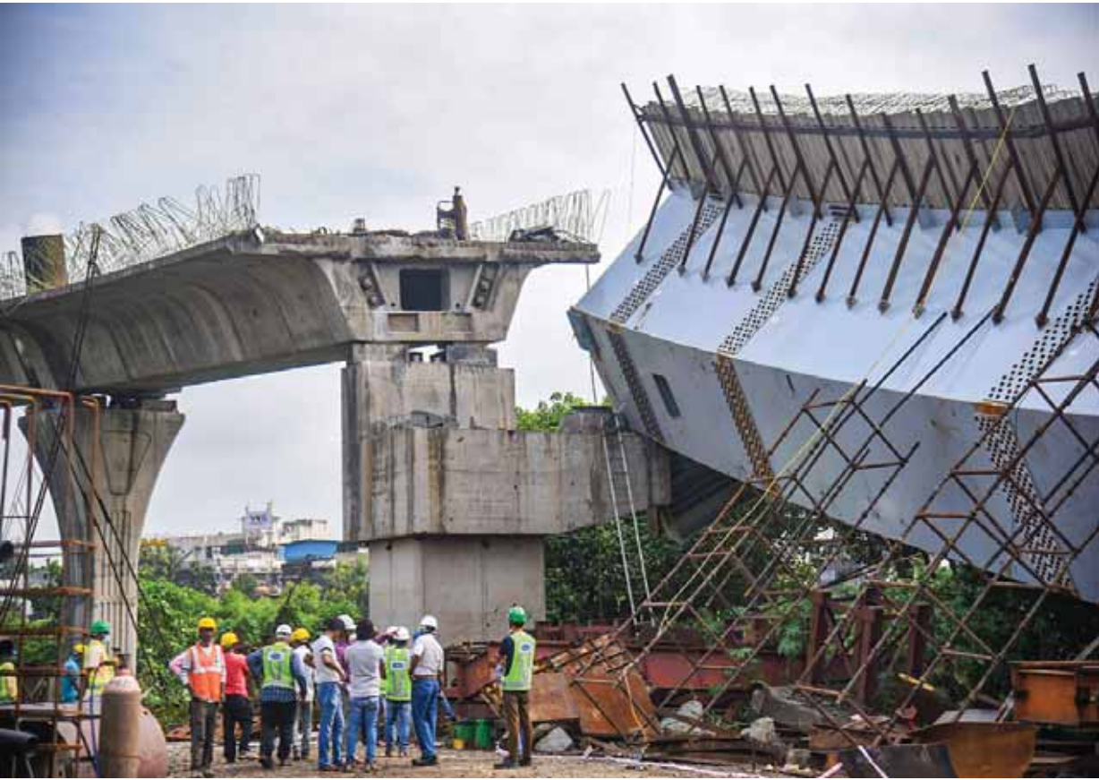
मुंबई में निर्माणाधीन प्लाईओवर का एक हिस्सा गिरने से एक दर्जन मजदूर घायल हुए
