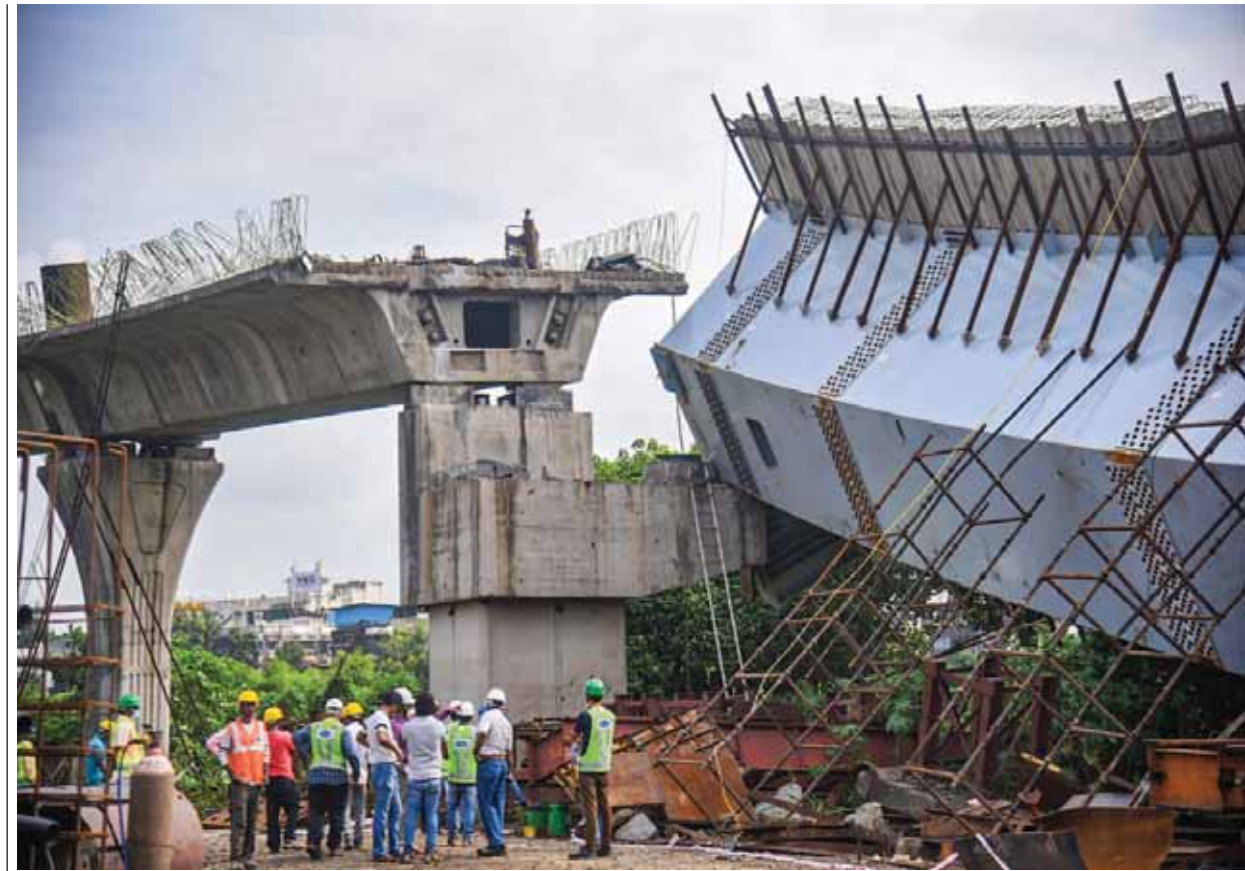
मुंबई में निर्माणाधीन प्लाईओवर का एक हिस्सा गिर गया, जिसकी वजह से आकर एक दर्जन मजदूर घायल हो गए
