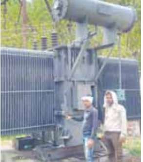
खराब हुआ ट्रांसफार्मर
