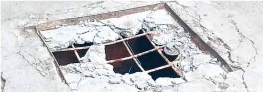
बीच सड़क पर टूटा पड़ा सीवर का चैम्बर का ढक्कन
