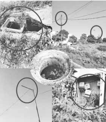
सेक्टर-85 में सीवरेज के ओपन ढक्कन, खम्भों पर नगदार्ड स्ट्रीट लाइट और बिजली के खाली पोल।
