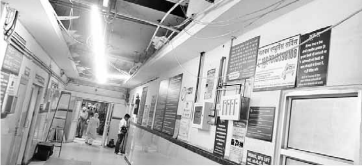
बीके अस्पताल के अपातकालीन कक्ष में लटकी हुई ट्यूब लाइट।
