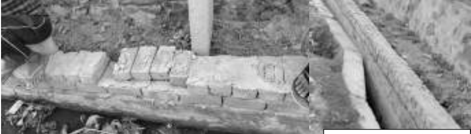
धुलावट में नाली निर्माण के दौरान ही हटी हुई ईंट। दूसरे चित्र में टूटी नाली।
