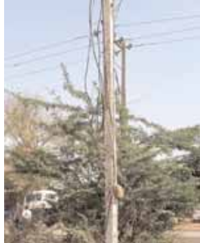
सोहना के गांव सांचौली में बिजली की लाइनों पर लटकी जर्जर हालत में टूटी तारें। रही हैं। जिससे बिजली सप्लाई तो गुल हो ही जाती है। साथ में जमीन पर लटकी तारों से जानलेवा हादसा होने की पूरी-पूरी संभावना रहती है। गांव निवासी बिट्टू यादव ने बताया कि तार टूटने के बाद यहां के 200 से
