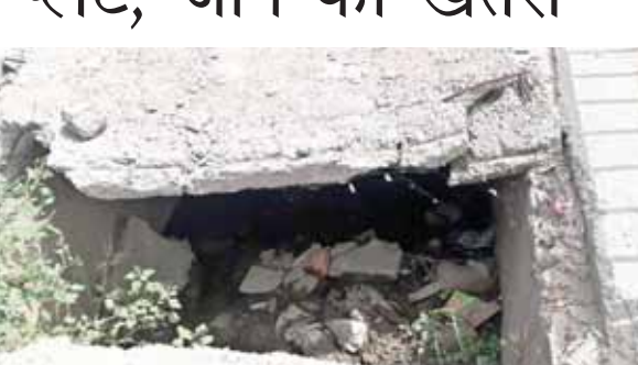
नाले को कंकरीट की प्लेटें बनाकर ढक दिया था। आस पास के ना-रिक, किसान, मजदूर या पैदल चलने वाले को नाले से किसी प्रकार की परेशानी न हो। लेकिन नाले पर लगाई गई प्लेटें जगह-जगह से टूट गई हैं। टूटी प्लेटों को बीते छह माह से बदला नहीं गया है। उठता यं टूटी प्लेटें किसी भी पैदल चलने वाले की जान ले सकती हैं।
