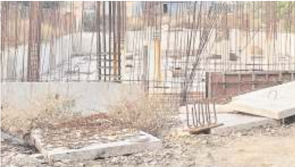
जर्जर होता निर्माणाधीन अस्पताल का भवन।
