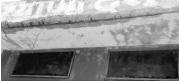
भवन की छत के साथ छज्जे से प्लास्टर गिरने के बाद साफ नजर आता सरिया।
