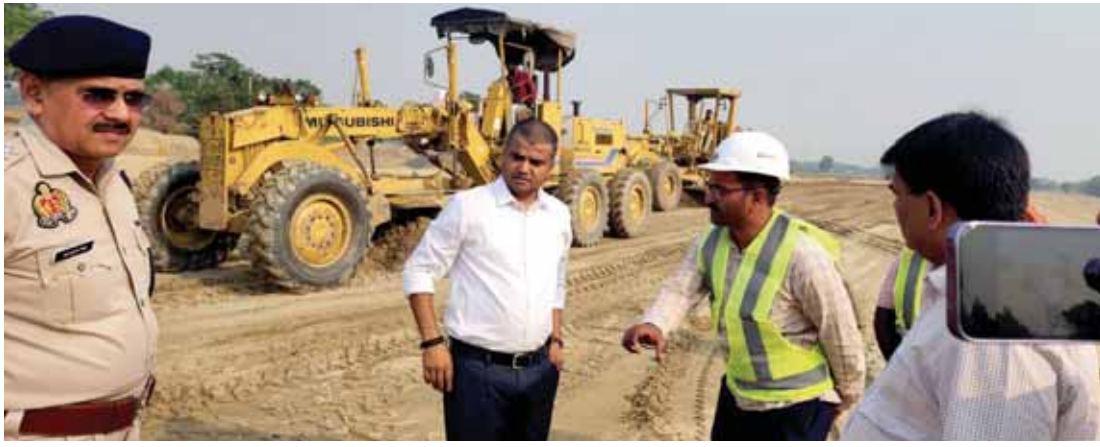
नेशनल हाइवे अथॉरिटी ऑफ इंडिया के द्वारा जेवर एयरपोर्ट से बल्लभगढ़ तक बनाई जा रही सड़क के निर्माण कार्यों निरीक्षण किया। गौतमबुद्धनगर के खिलाधिकारी मनीष कुमार वर्मा। इस दौरान उन्होंने निर्धारित समय अर्थाथ में गुणवत्ता के साथ काम पूर्ण करने के अधिकारियों को निर्देश दिए।
