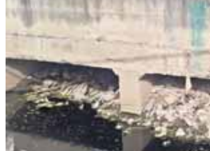
अंबेडकर बाईपास चौक के निकट बनी बरसाती पुलिया में फंसा कूड़ा-कचरा।
