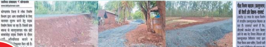
कोण्डागांव जिला में लोक निर्माण विभाग द्वारा ग्राम बफना से मालगुजारापा गांव छोटे बनबंजोड़ा तक सड़क निर्माण के कार्य 2 करोड़ 22 लाख 32 हजार रुपए की लागत से 2.20 किमी लंबाई किया जा रहा है। जो मेसर्स कुशवाहा कांस्ट्रक्शंस कंपनी के द्वारा बनाया जा रहा है। इस सड़क निर्माण में भारी अनियमितता को लेकर में दिन मंगलवार को पायनियर राष्ट्रीय अखबार में 21 मई के अंक में 2 करोड़ 22 लाख से अधिक की सड़क निर्माण में अनियमितता नमक समाचार प्रमुखता से प्रकाशित किया गया था।
